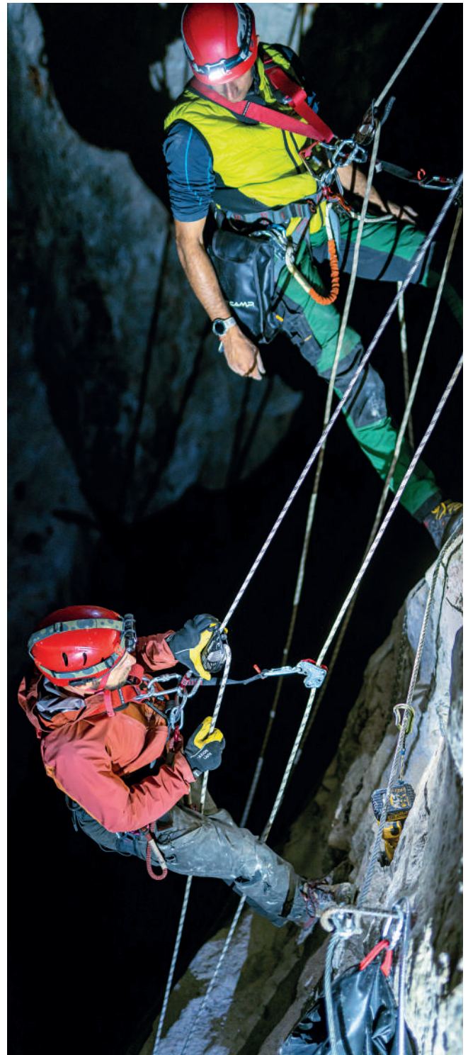
A sliver of light illuminates the work of Emilio Malugani and Andrea Cari in a barite mine. Juegos de luces y sombras durante los trabajos de seguridad en una mina de barita realizados por los técnicos Emilio Malugani y Andrea Cari Cortabbio, Italy (courtesy of Parco Minerario di Cortabbio and Emilio Malugani & C. snc, ph.Giovanni Danieli).
