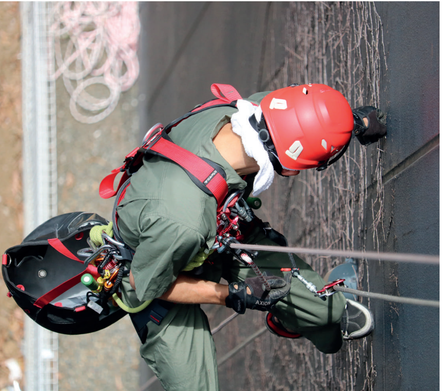
Taizo Fukunaga doing rope access maintenance on the Caravan headquarters. Taizo Fukunaga realiza operaciones de mantenimiento con cuerdas en las instalaciones de Caravan. Tokyo, Japan (courtesy of Caravan Co. Ltd., ph. Ryuichi Ihara).
